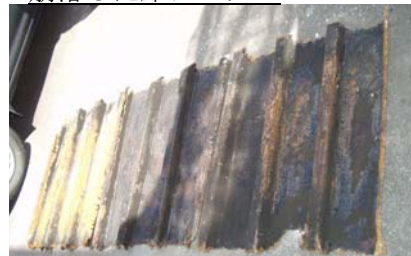
崩落した床アングル
