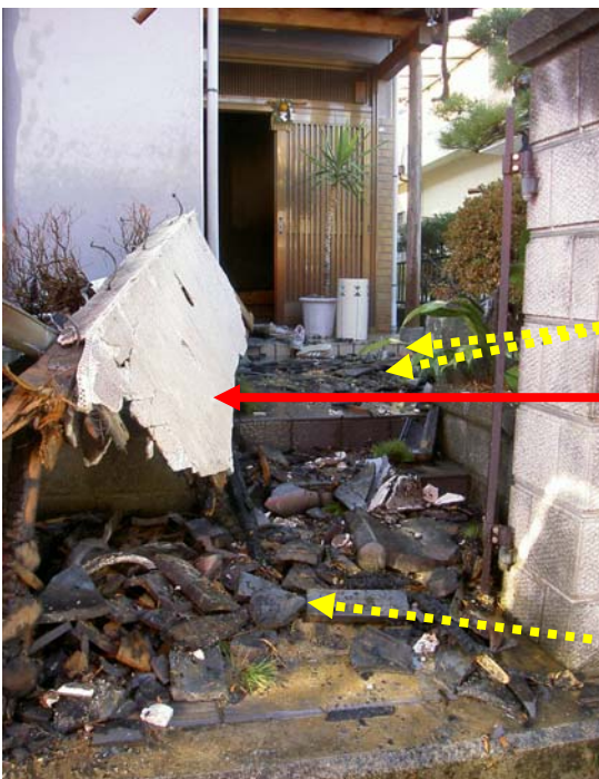
崩落した軒先の状況
