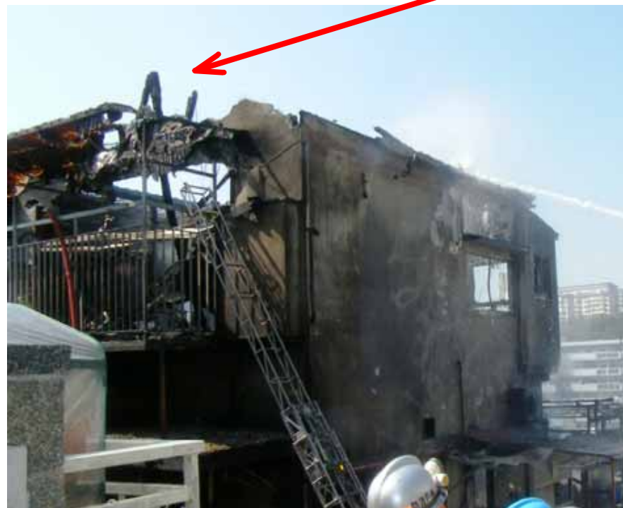
残火整理（火災後期）時に小屋組とともにソーラーシステムが落下したあとの状況
