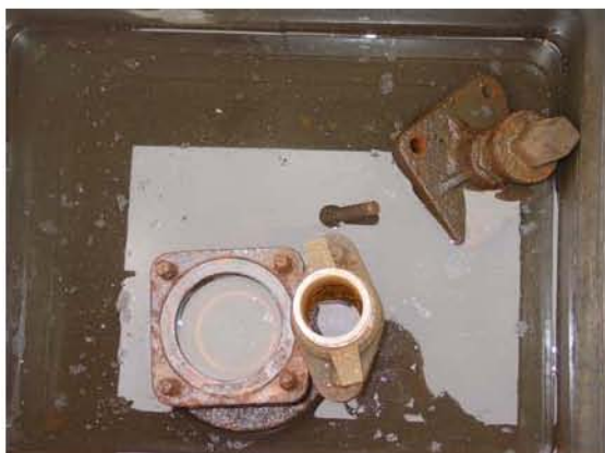
放水弁（制水弁）の離脱状況
