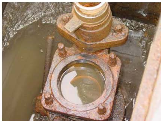
ボルト等の腐食状況
