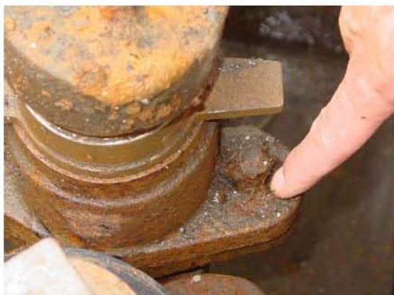
ナットの腐食状況
