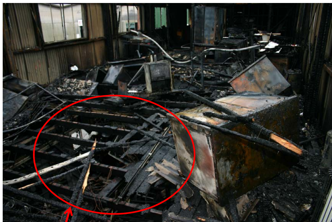
崩落後、2Fからの写真
