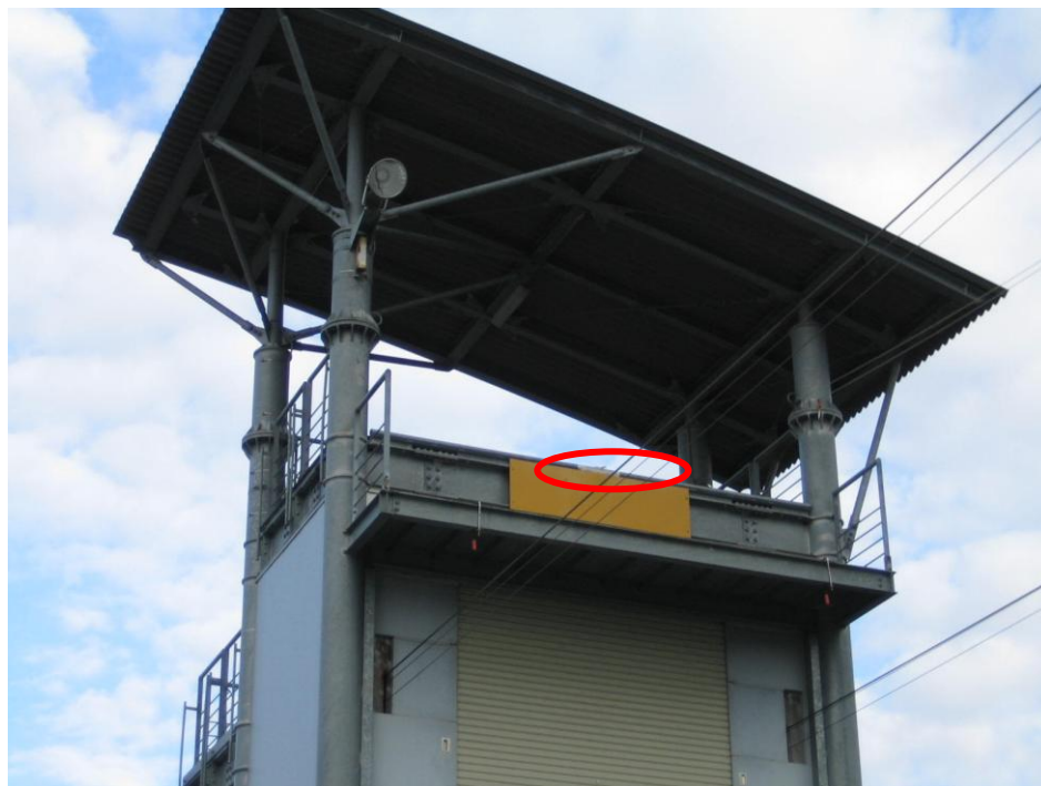
救助訓練（ロープブリッジ救出）中の事故写真
