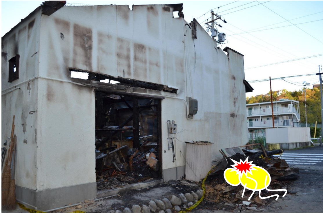
軒が崩落し瓦礫の下敷き になった当事者A
