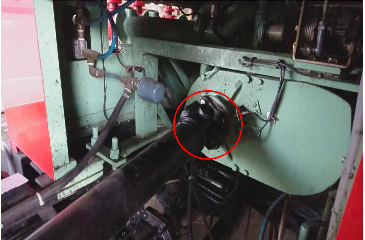
ポンプ駆動シャフト取り付けボルトの状況
