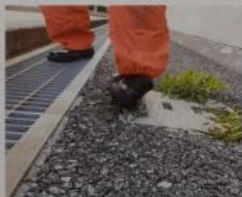
・踏溝の段差 高さ約3cm
